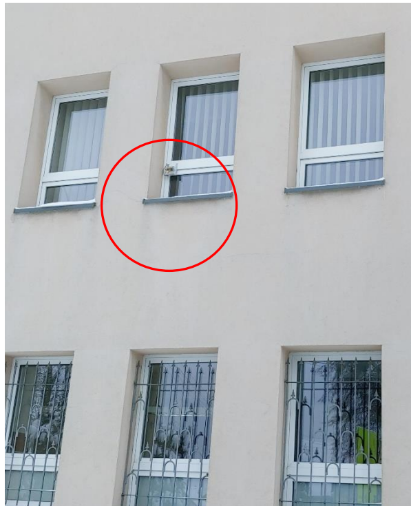
Rys. 4. Zainstalowany czujnik pyłu zawieszonego - widok na zewnątrz budynku.
