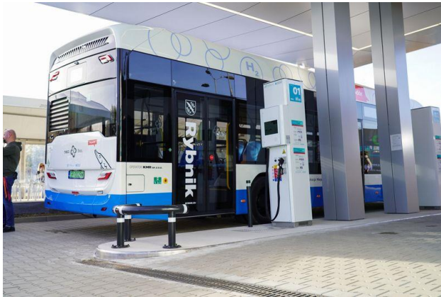
Stacja tankowania wodoru w Rybniku, źródło: rybnik.eu
