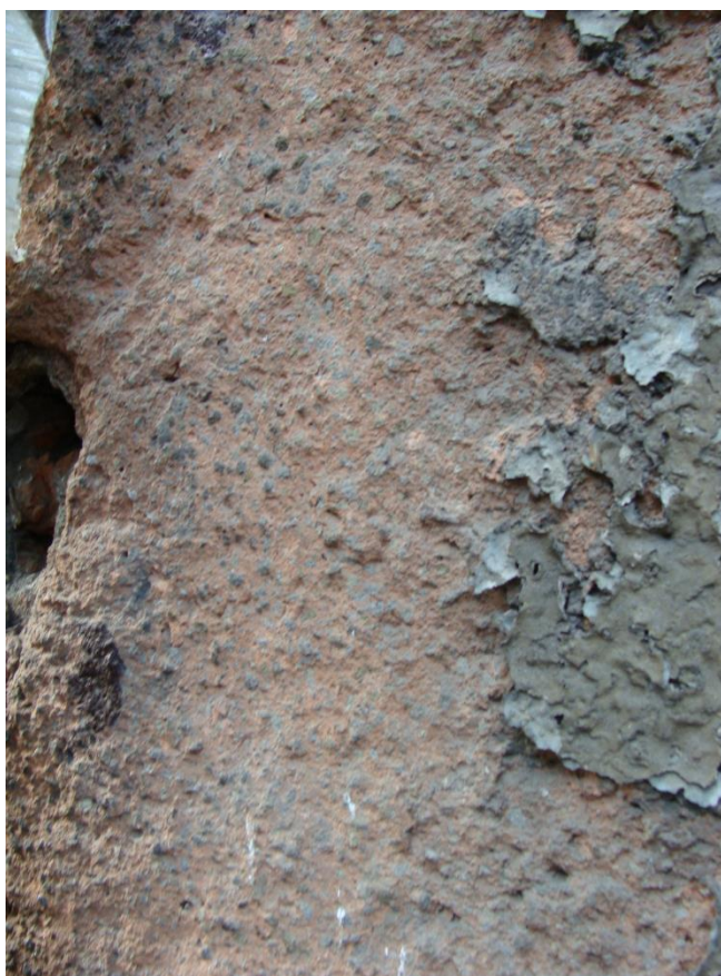
Ilustr. 12 Bytom, ul. Prusa 25. Fragmentarycznie odkryty tynk szlachetny z kruszywem pod warstwami wtórnej farby i zabrudzeń
