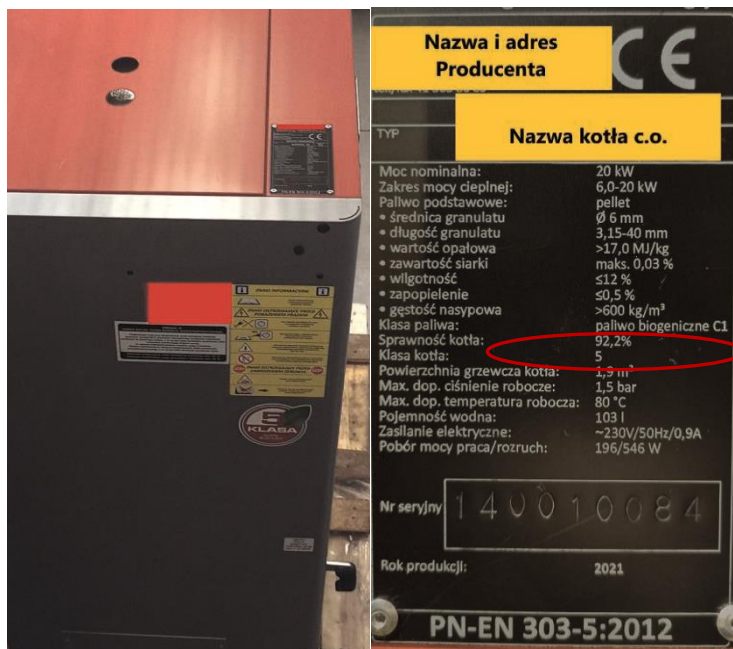
Rys. 8. Tabliczka znamionowa kotła
