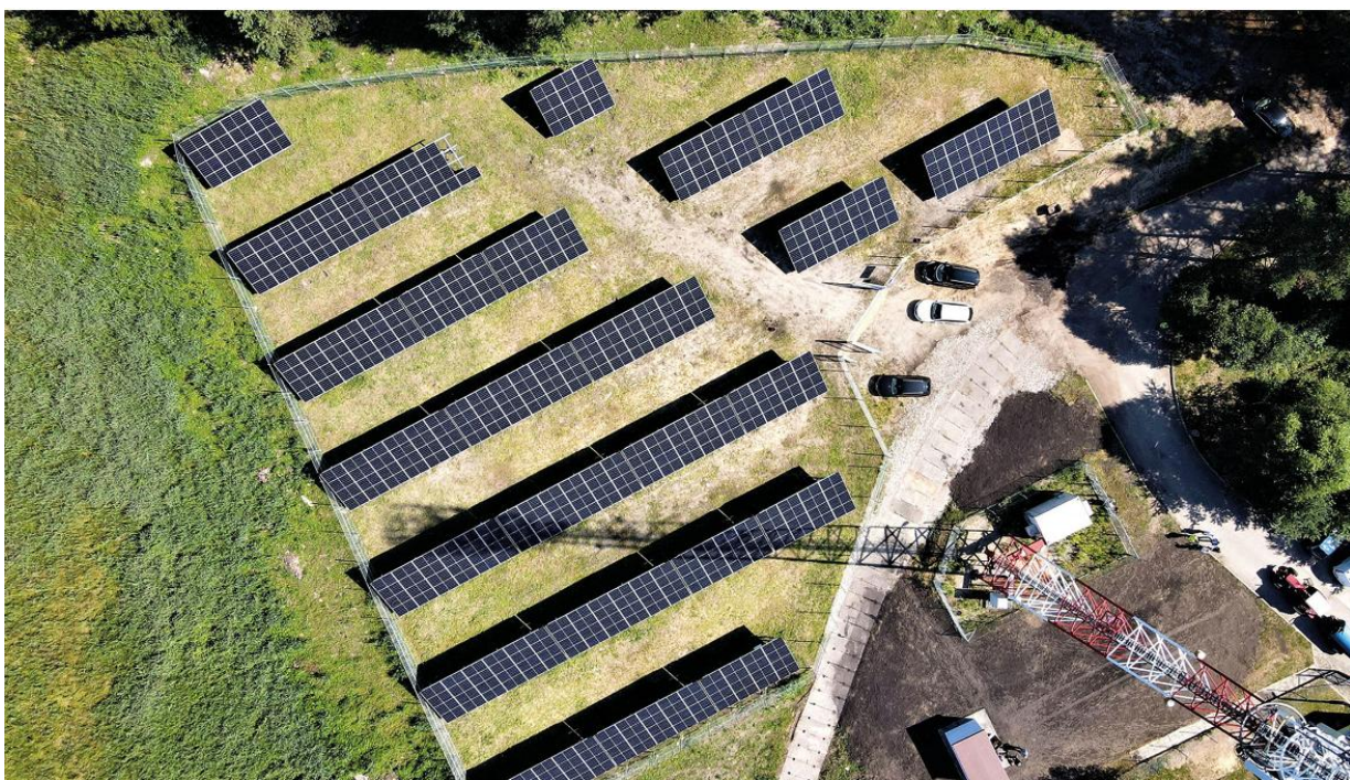
Fotovoltaická instalace pro potřeby Městské čistírny odpadních vod a vzdělávacích institucí, zdroj: Město Kalety
